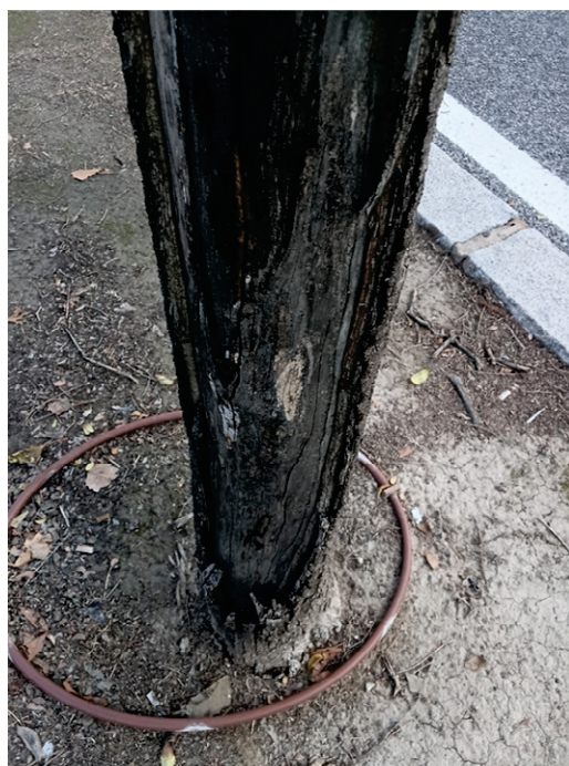
Herida longitudinal por asolamiento desde el cuello hasta la parte superior con madera vista/pudrición.
