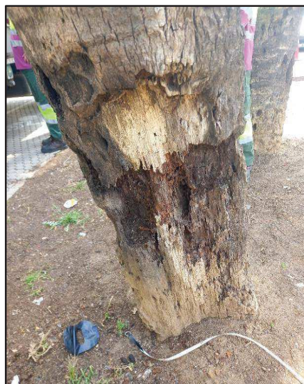
5. Detalle zona degradada
