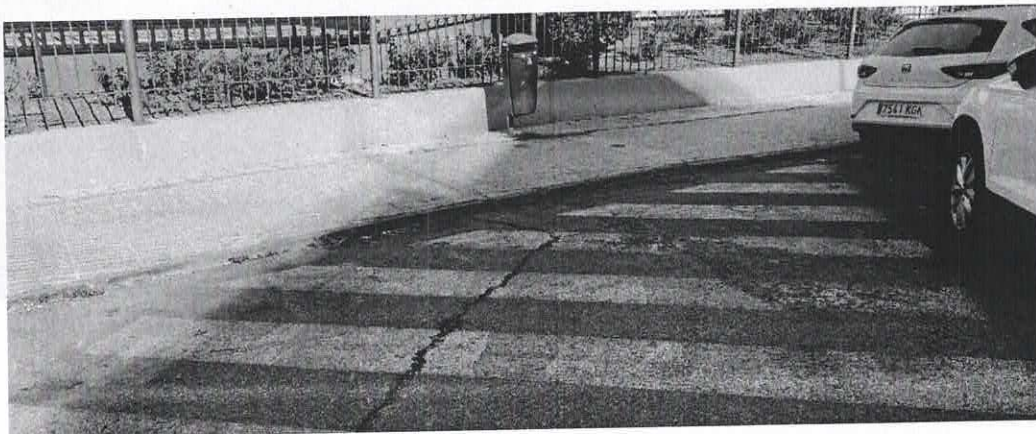
En la calle Sinaí esquina con calle Muñoz Seca este paso de peatones no tiene rebaje en la acera para acceso a personas con movilidad reducida
