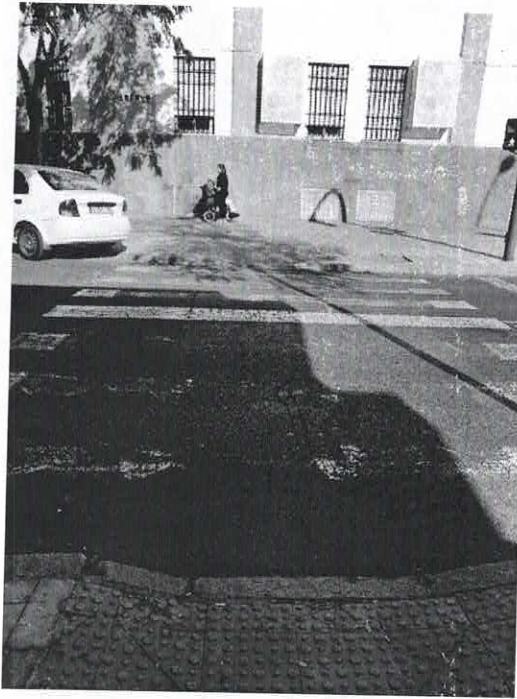
Señalización horizontal en un paso de peatones en calle Arroyo
